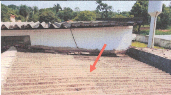
Telhas desgastadas com o tempo de uso
