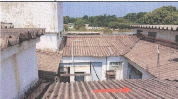
Telhas desgastadas com o tempo de uso
