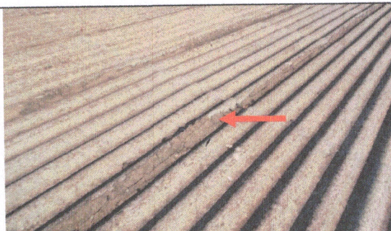
Telhas desgastadas com o tempo de uso
