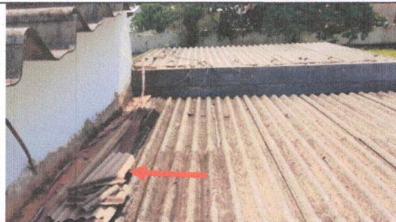
Rufo inadequado e telhas quebradas
