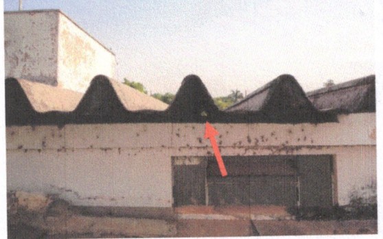
Telha sem proteção
