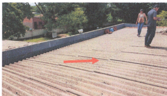
Telhas desgastadas com o tempo de uso
