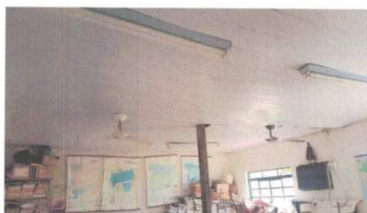
Selagem de tesoura e ondulações no forro PVC
