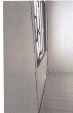
Aberturas nas paredes da cozinha
