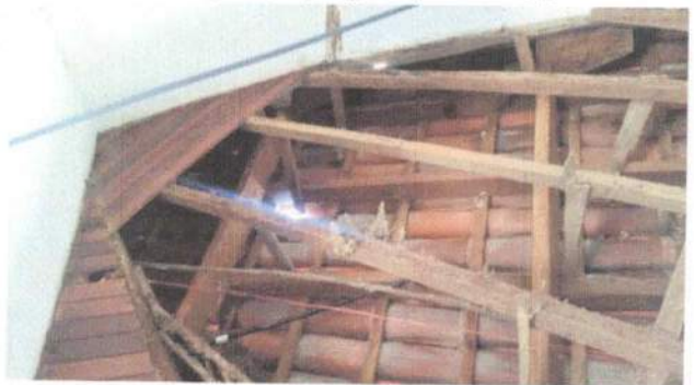
Estrutura do telhado danificada
