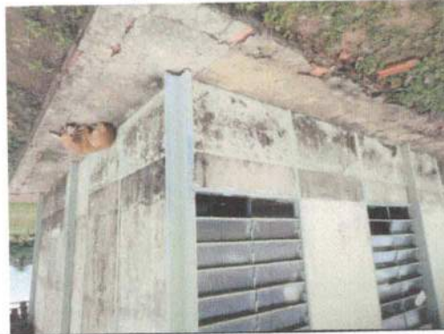
Umidade na Parede
