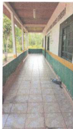
Paredes do corredos danificadas
