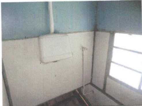
Umidade na Parede
