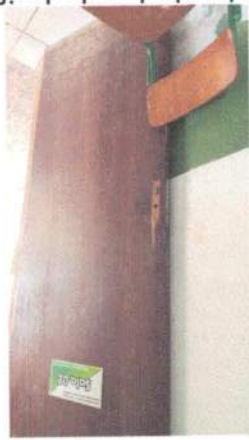
Porta da sala de aula danificada
