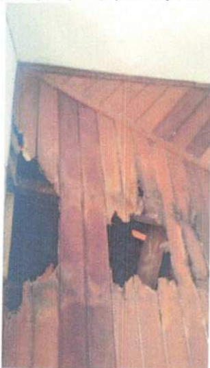
Forro de madeira danificado
