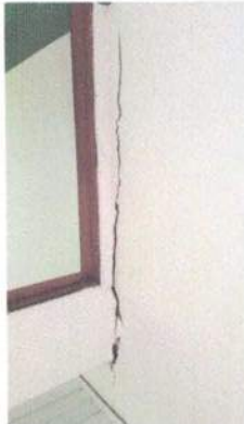
Aberturas nas paredes da cozinha
