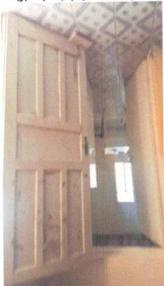
Porta do consultório danificada
