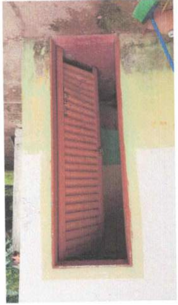
Porta do único banheiro danificada
