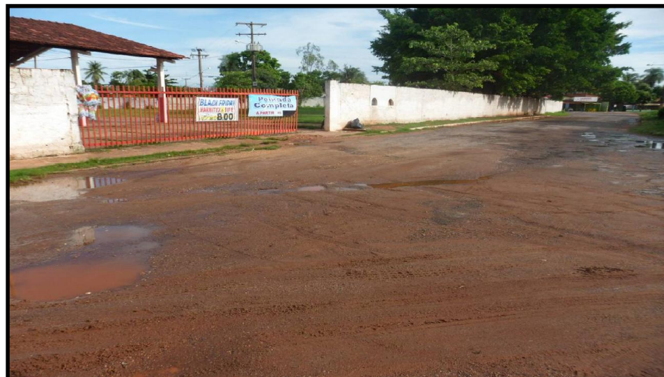
Foto - 07 e 08: Em frente ao Clube Seu Que Brilha, inicia-se a estaca 0 (zero) da implantação do traçado da Av. Santo Antônio; Como se vê na foto, o pavimento encoberto por sedimento de areia, prolongando o acúmulo de água na superfície deteriorada.
