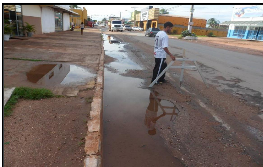
Foto - 02- Pavimento desgastado com descolamento de ligantes e, acumulo d'água no bordo esquerdo numa extensão 85m, em virtude da péssima condição do instrumento de drenagem superficial (sarjeta).
