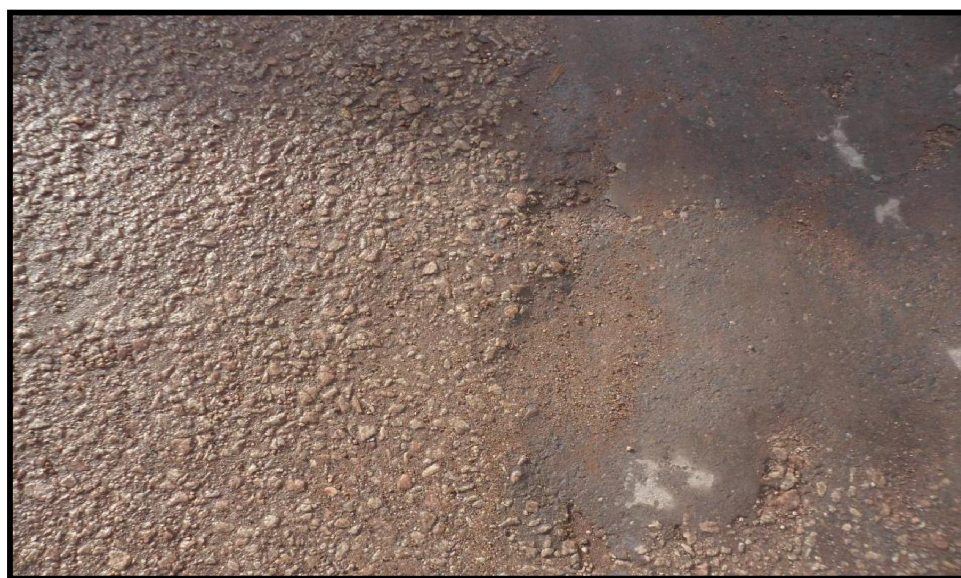
Foto - 03 e 04: Nesta foto mostra a condição que se encontra o pavimento, apresentando desagregação e descolamento de ligantes.
