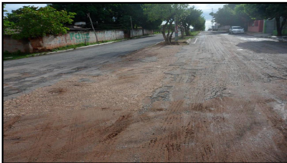
Foto - 09: O pavimento envelhecido, sem elasticidade, com trincas longitudinais e panelas formadas pela descolagem das camadas de lama asfálticas aplicadas anteriormente.
