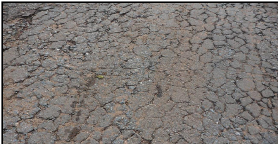
Foto - 10: O envelhecimento do pavimento por oxidação fez com que fragmentasse a superfície, em trincas interligadas (tipo couro de jacaré).
