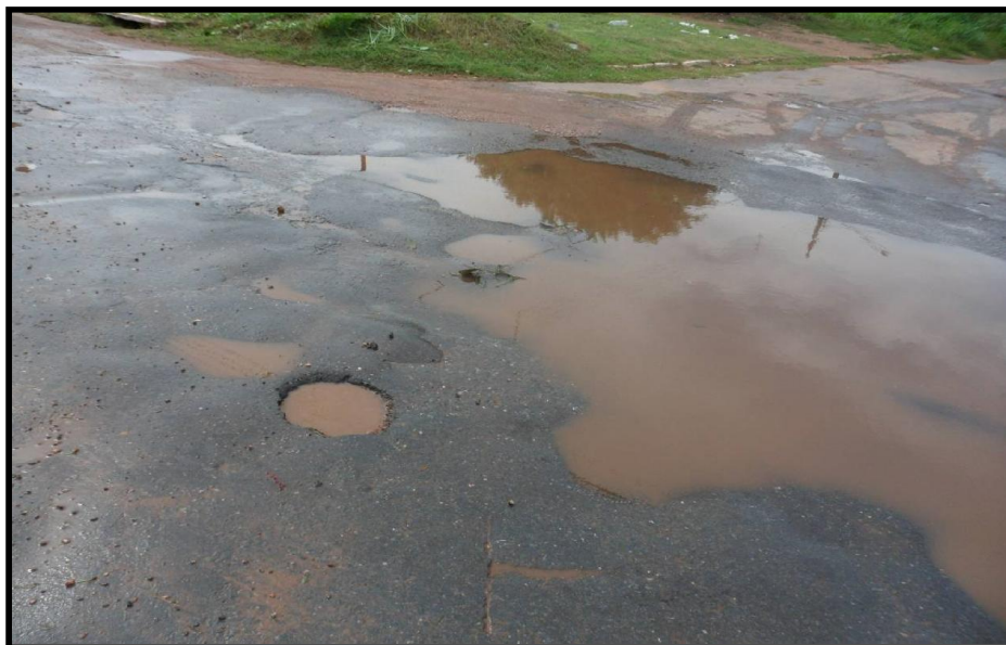
Foto - 17: Foto mostra as intervenções de tapa buracos ao longo dos anos e panelas profundas que atinge a base estrutural do pavimento; Mais um caso de mau funcionamento do dispositivo de drenagem superficial.
