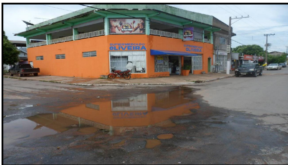
Foto - 16: Neste trecho, o acúmulo de água atingiu a base do pavimento, onde deverá realizar reforço estrutural localizado.
