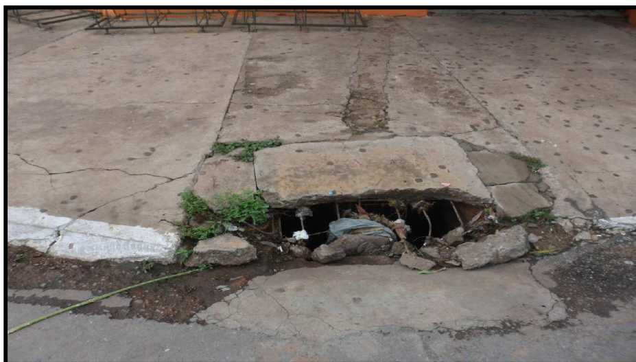
Foto - 18: Boca de lobo praticamente destruída e assoreada, com a entrada d'água acima do nível da sarjeta.
