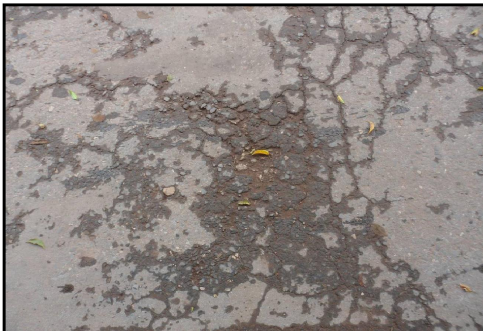
Foto - 11 e 12: Superfície com trincas e fissuras desenhada na lama asfáltica.
