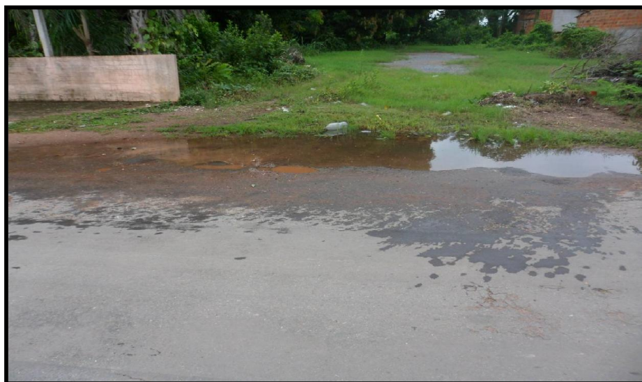
Foto - 20: Este local o pavimento encontra-se com problema estrutural, por causa do acúmulo d'água localizado nas proximidades da estaca 74.
